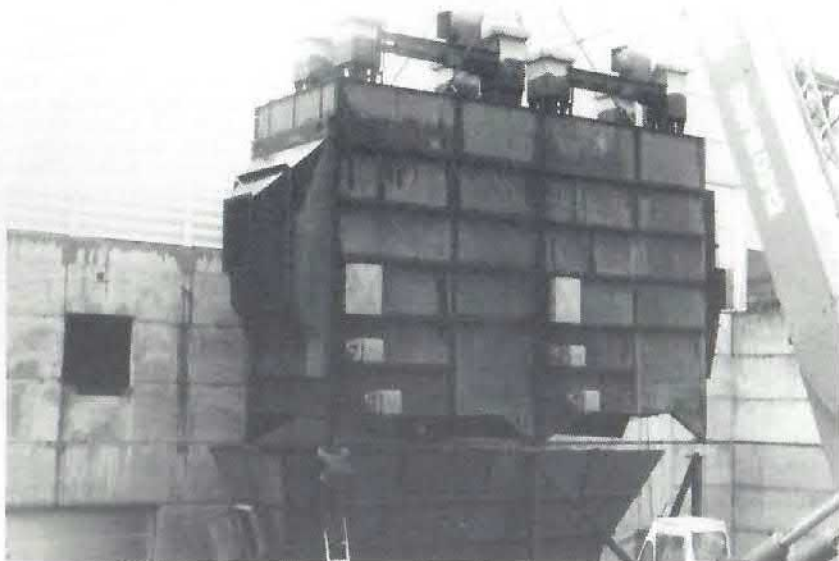
Her monteres filterhus på svajebensunderstøtning
